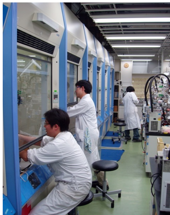
給・排気設備 (コンピューター制御)
